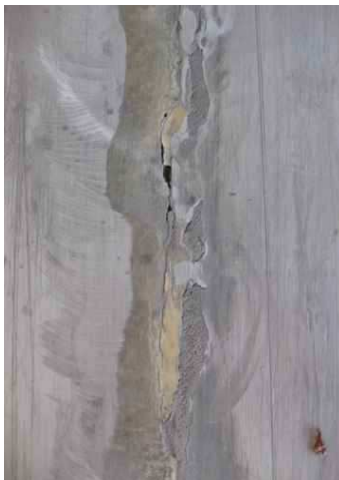
Defekte Fuge (mit oder ohne Profil)
