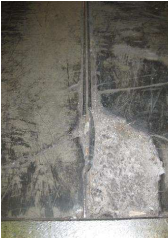
Völlig deformiertes Fugenprofil mit hohem Gefährdungspotential!
